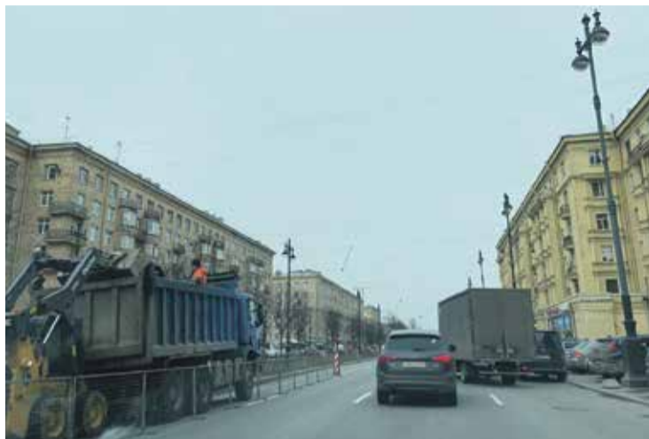
На Московском проспекте от набережной Обводного канала до площади Победы появятся 335 современных опор с 670 светильниками.
